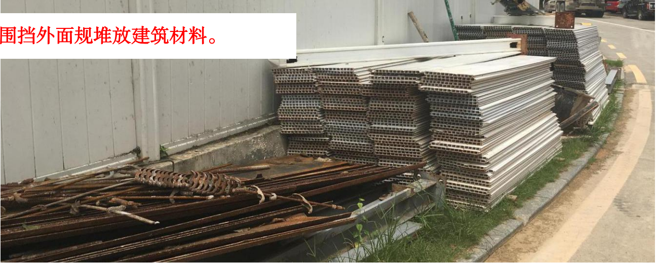
围挡外面规堆放建筑材料及垃圾。
