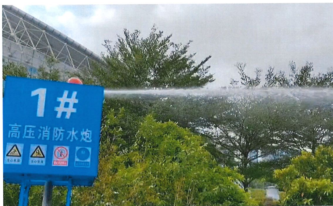
5、永临结合-临时消防系统
